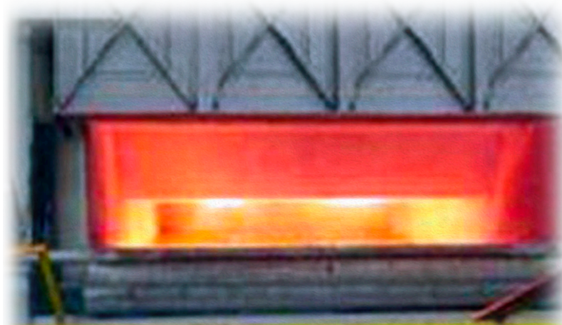
Fig. # 3 Quemadores en bóveda radiante en proporción de fuego alto.
